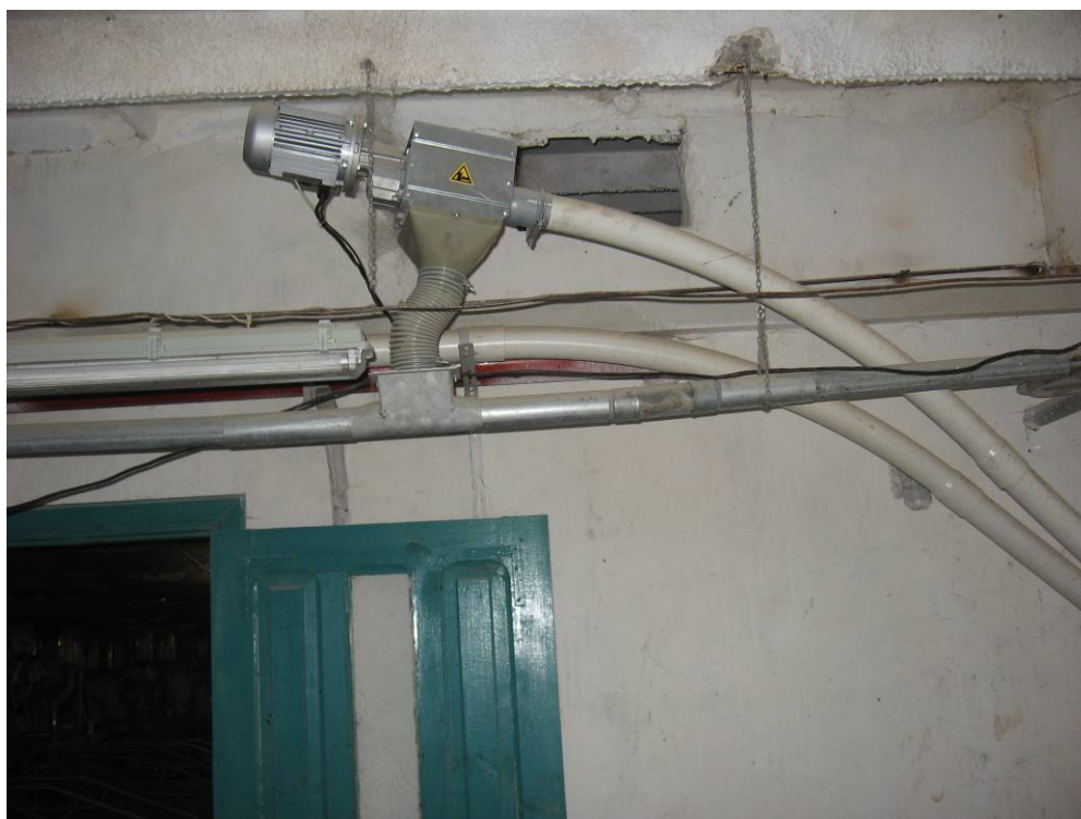
Рисунок 8 – Вид на привод и кормовые трубы линии поперечной раздачи
