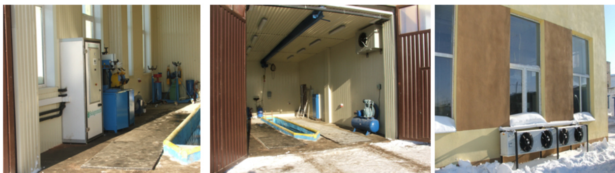
Рисунок 124 – Экспериментальная теплонасосная типа «воздух-воздух» мощностью 35 кВт для обогрева трех производственных помещений пункта технического обслуживания и ремонта тракторов и сельхозмашин
