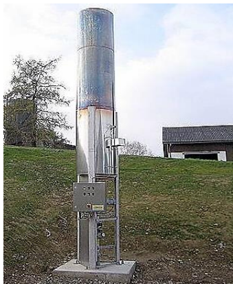
Рисунок 83 – Общий вид автоматизированного факельного устройства
