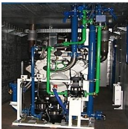
Рисунок 86 – Когенерационная газовая установка КГУ-250 (вид сбоку)
