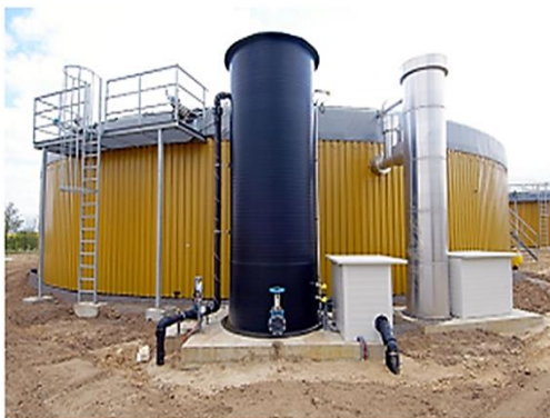
Рисунок 89 – Общий вид десульфуризатора для очистки биогаза от сероводорода
