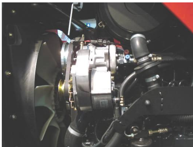
Рисунок 3. – Генераторная установка с дополнительным генератором
