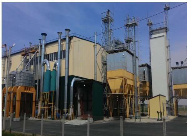
Рисунок 7. – Комплекс оборудования КОС-10
