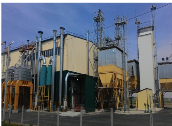
Рисунок 7. – Комплекс оборудования КОС-10
