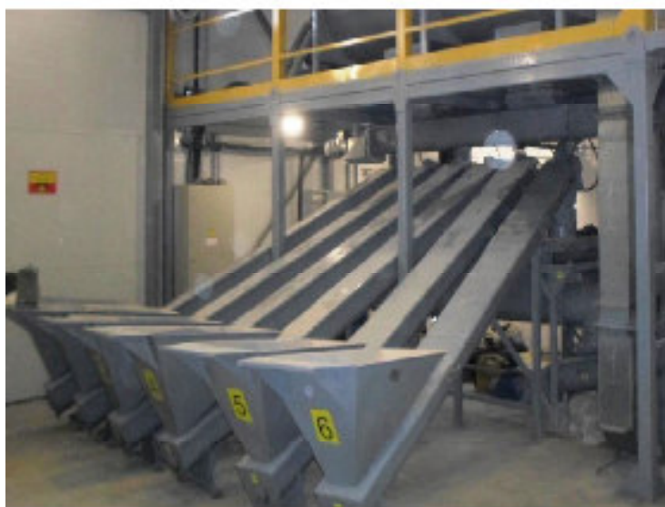
Рис. 2. – Общий вид контейнеров с установленным технологическим оборудованием
