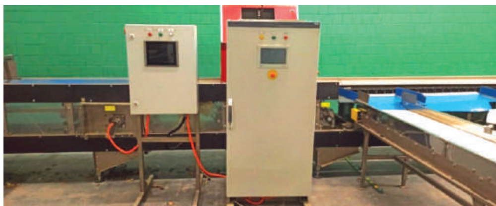
Рис. 3. Система технического зрения СТЗ линии сортировки ЛСП-4
